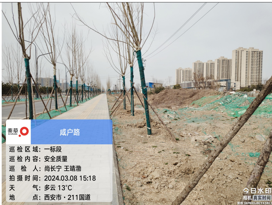
①侧分带（年前）新栽植乔木单边支撑，已倾斜②支撑高低不一，撑脚不同向；
